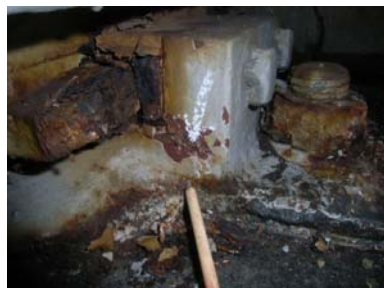
写真-1. 沓座破損状況
