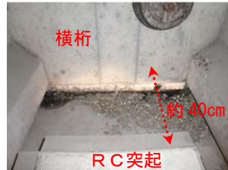
写真-3 横桁とRC突起の遊間
