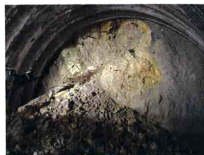
写真-1 切羽鏡面崩壊状況
