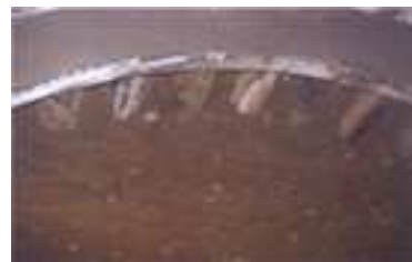
写真-1 パイプルーフ鋼管間の土砂の抜け落ち
