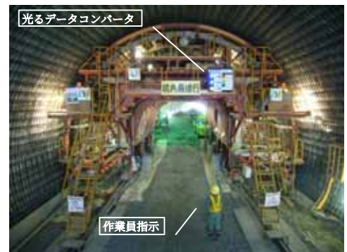
写真-2 圧力管理(光るデータコンバータ)
