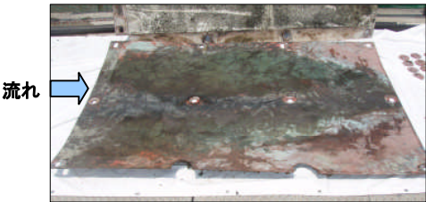
写真-2 損傷箇所
