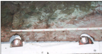
写真-1 FRPの損傷
