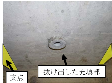
図-4 垂直削孔試験体の裏面
