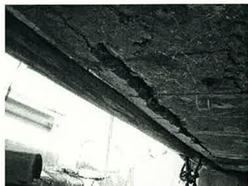
写真1 塩害の変状の様子
