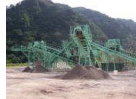
写真 2 粒度調整・分級設備
