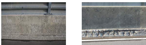
写真-1 スケーリングの状況
