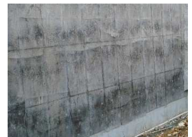
写真2 現場で発生した色むら
