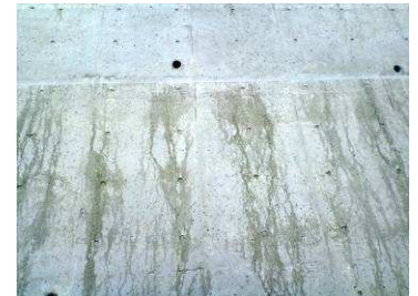
写真1 現場で発生した砂すじ
