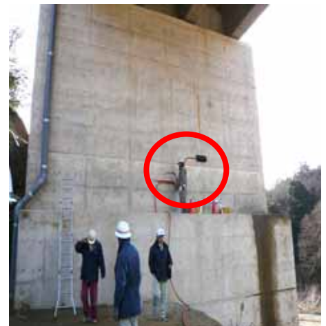
図 - 1 対象構造物と観測ひび割れ位置
