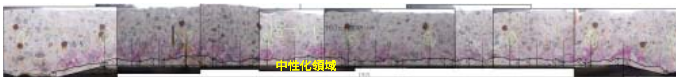
写真-1 撤去床版断面の中性化の状況
