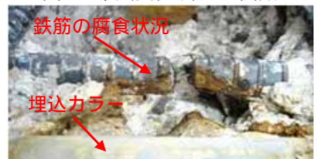
図7 鉄筋の腐食状況 (S-2)
