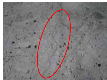
図-5 ひび割れ注入跡
