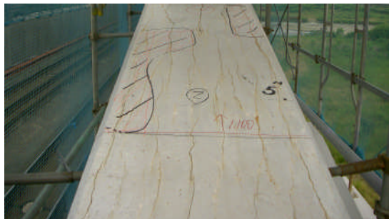
写真 1 直線的なひび割れ状況
