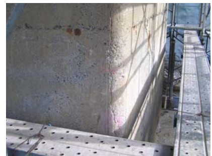
写真-1 ひび割れの状況
