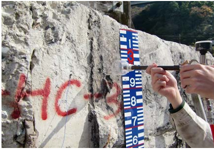
図-2 ひび割れ部試験状況
