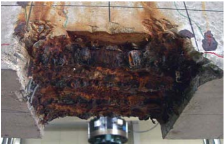
図－6 かぶり剥落箇所の腐食状況
