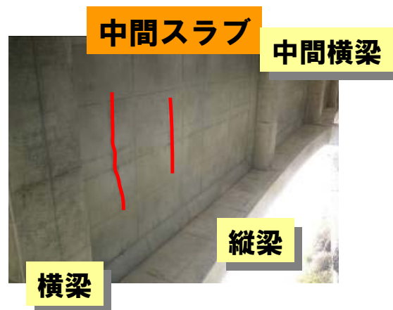
写真-1 高架橋スラブひび割れの例
