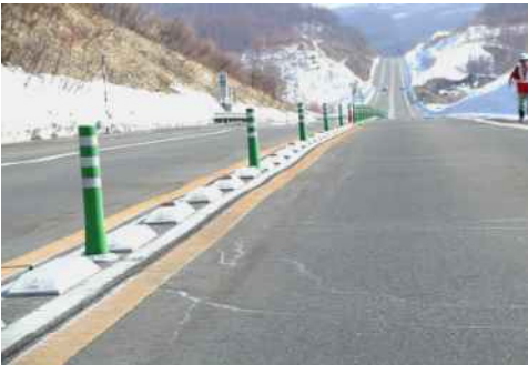
写真 1 切土部の路面凍上の発生
