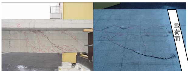
No.2 破壊状況
