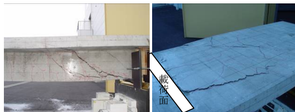
No.3 破壊状況
