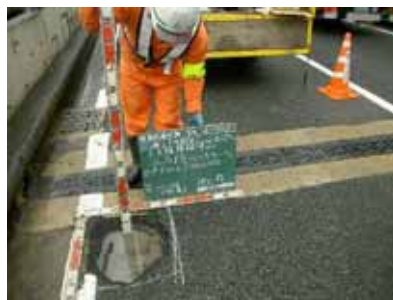
写真-1 ポットホールの例
