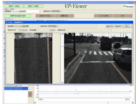
図-6 排水性舗装の面荒れ例
