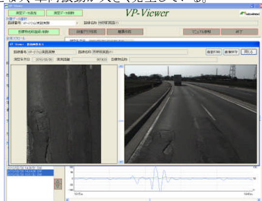
図-5 パッチング部の破損例
