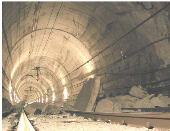
写真-1 新潟県中越地震における被害事例
