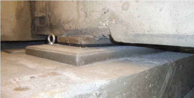
写真-4. 沓座(復旧後)
