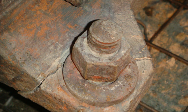
写真-2. 沓の変状(亀裂)
