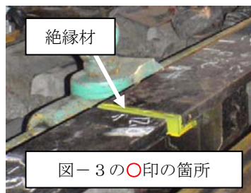
写真-2 ガード端部用絶縁材
