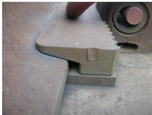
写真 2 軌間内側インシュレーターの隙間
