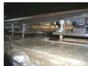
写真-4 タイフプレート下の隙間
