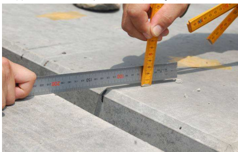
図 3-6 スラブ板の段差
