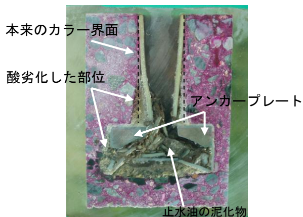
図1 変状した埋込カラーの断面
