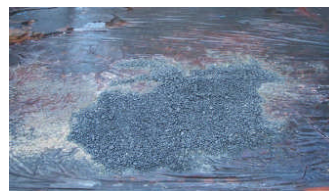
写真-2 樹脂 B のてん充不足状況
