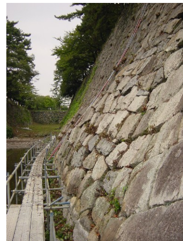
写真-1 石垣の変状状況
