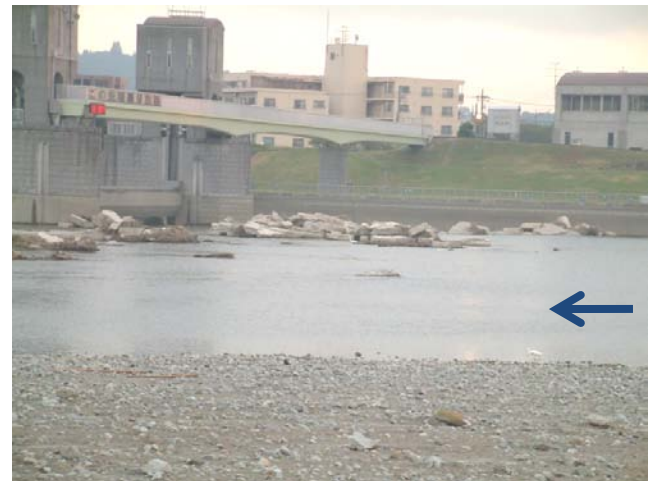
Fig.1 多摩川宿河原堰上流護床工の被災 (H.19年9月台風9号による。同年10月三輪撮影)
