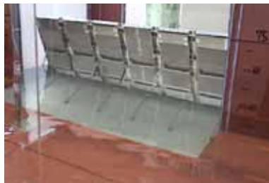
図-3 起立状態のフラップゲート
