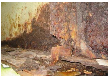
写真-1 桁端部の腐食
