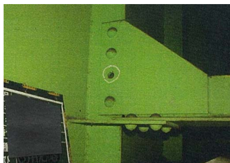
写真-2 対傾構のボルト脱落
