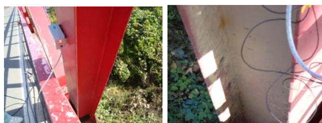
(a)第1 径間_上流側：健全 (s1-du1) (b)第1 径間_下流側：腐食 (s1-dl1)
