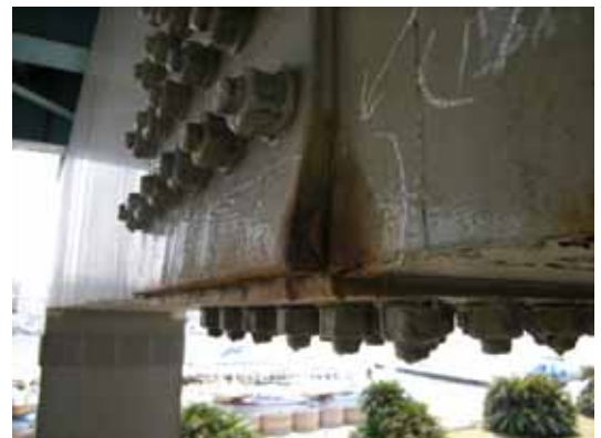
図-1 塗装仕様のボルト継手部における腐食事例
