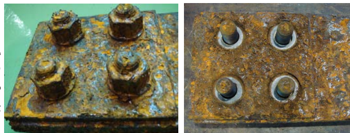
a)曝露後の表面腐食状況 b)ナット撤去後 図-2 円周切欠き丸鋼試験片
