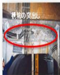
図-1. とう道立坑取付部被災事例
