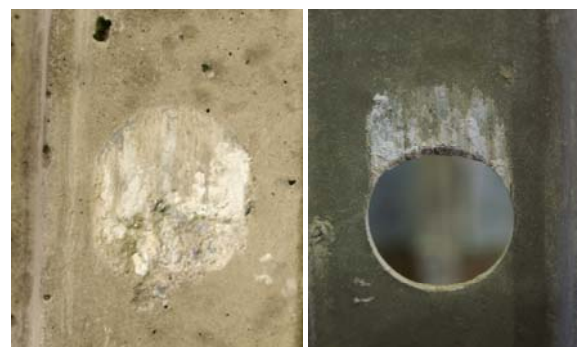
図-5 試験体解体写真
