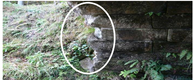
図-5 輪石欠落箇所（我山橋）
