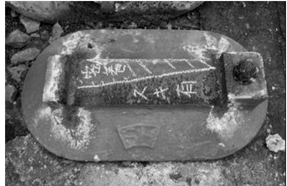
Photo.1 沓の接触面状況
