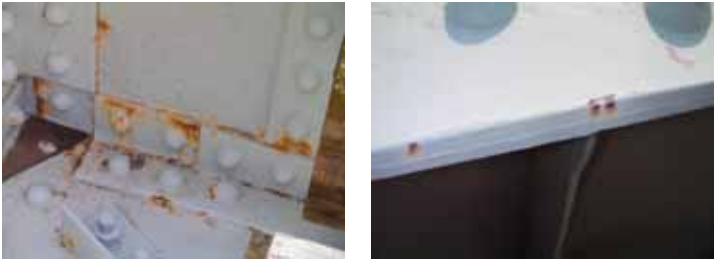
(a) 添接部 (b) フランジエッジ部 図2 塗装系 G7 の発錆状況
