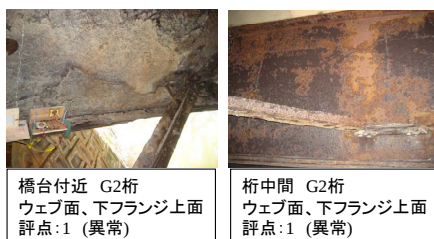
(1) Z 橋腐食状況例
