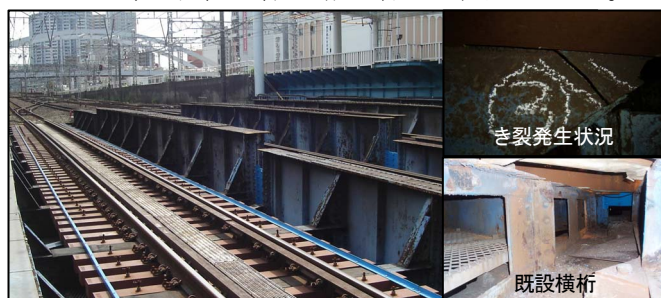
写真-2 全量・既設横桁・亀裂発生状況写真
