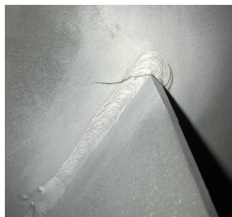
図1 垂直補剛材上端部での疲労亀裂
