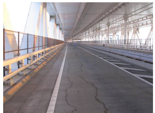
図1 SFRC 路面の状況（ひび割れ補修済み）
