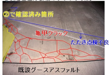
③表層全面除去後のクラック状況
