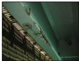
写真2 コンクリート剥離状況
