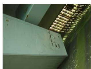
写真5 橋脚ひび割れ状況
