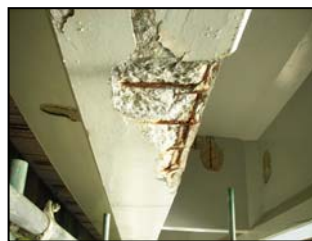
写真4 主桁の損傷状況
