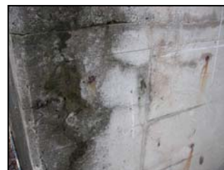
写真3 橋台のひび割れ状況
